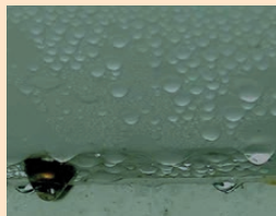
取り付け前結露の様子
